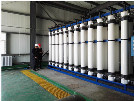
青海盐湖佛照蓝科锂业股份有限公司 反渗透系统超滤装置
