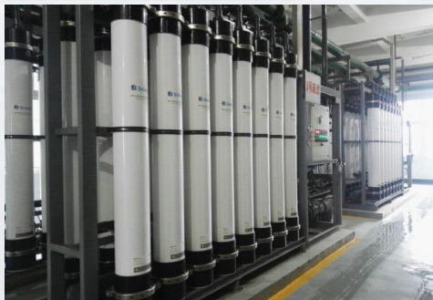
江阴热电有限公司超滤系统
